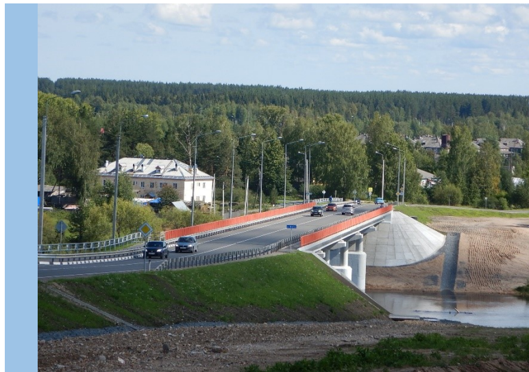
Реконструкция мостового перехода через реку Вага на км 2+067 автомобильной дороги Вельск – Шангалы
